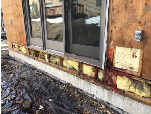
Bldg E1 Unit #11 Discoloring
