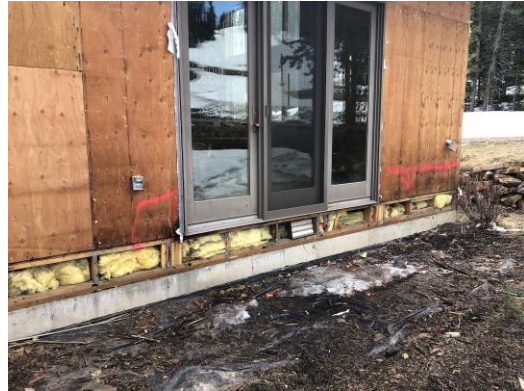
Bldg E1 Unit #8 Discoloring
