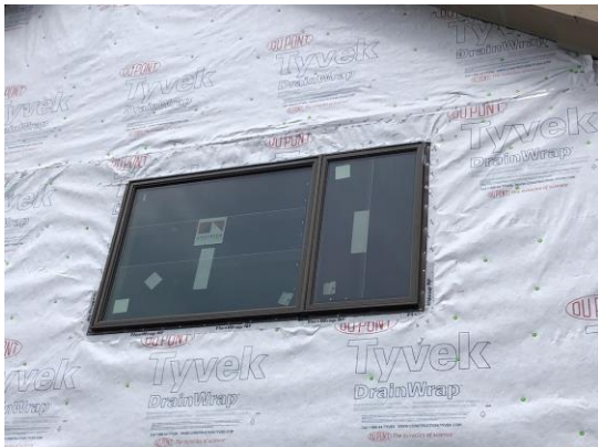
Bldg E3 Unit #25 Upper Window
