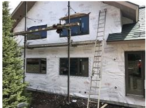
Bldg E2 Unit 23 Upper Window
