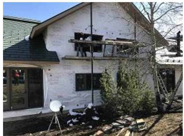
Bldg E1 Unit #10 Upper Window
