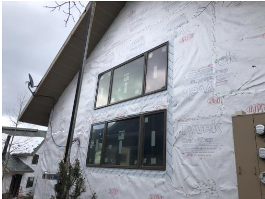
Bldg E3 Unit #24 Upper Window
