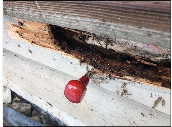
Bldg E3 Unit #9 Rim Joist
