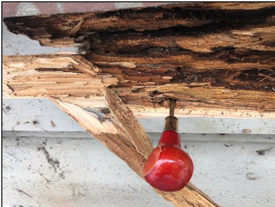
Bldg E3 Unit #9 Rim Joist
