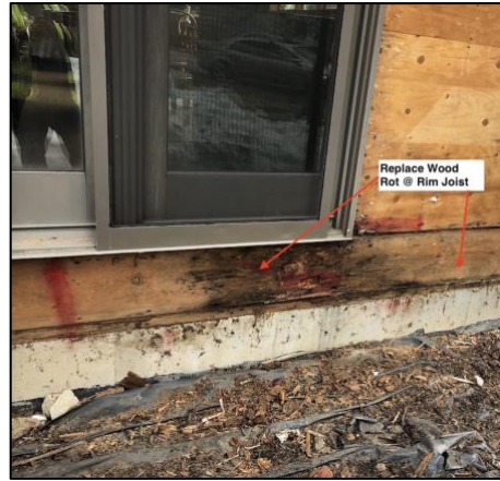
Bldg E1 Unit #8 Replace Wood Rot @ Rim Jst
