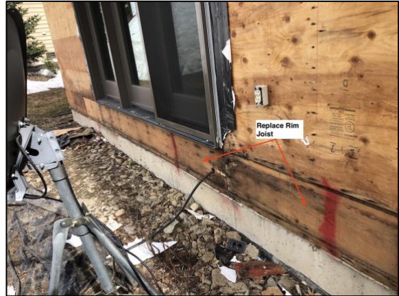
Bldg E1 Unit #11 Replace Wood Rot @ Rim Jst
