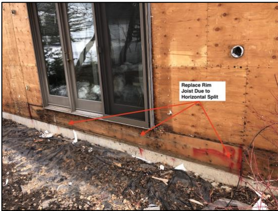
Bldg E1 Unit #10 Replace Wood Rot @ Rim Jst
