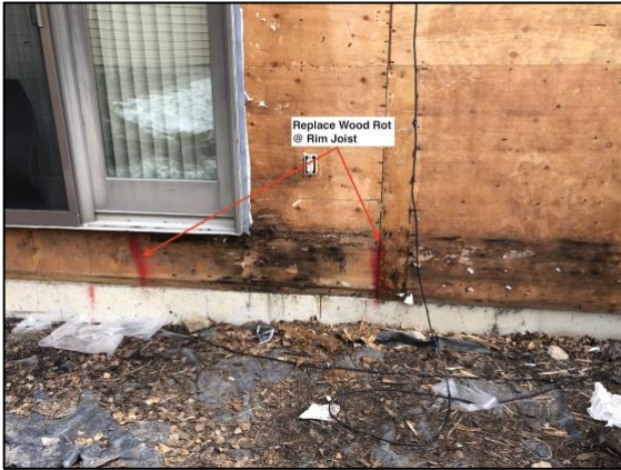
Bldg E1 Unit #9 Replace Wood Rot @ Rim Jst
