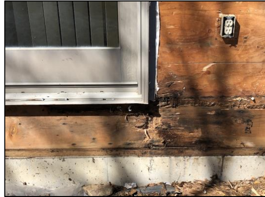
Bldg E1 Unit #9 Under Patio Door
