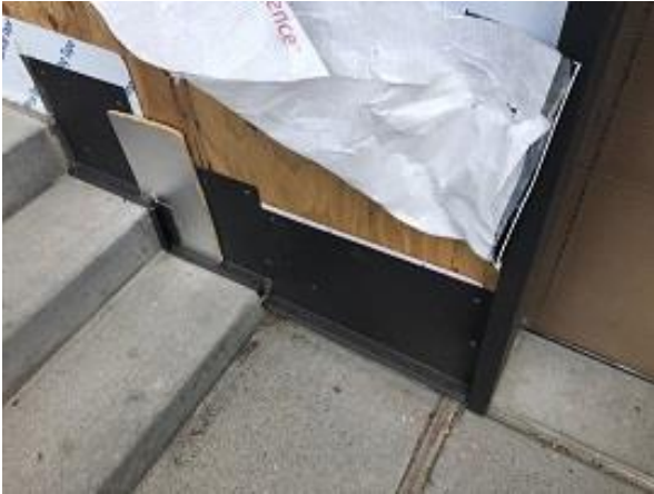
Bldg E3 Unit #24 Stoop Flashing
