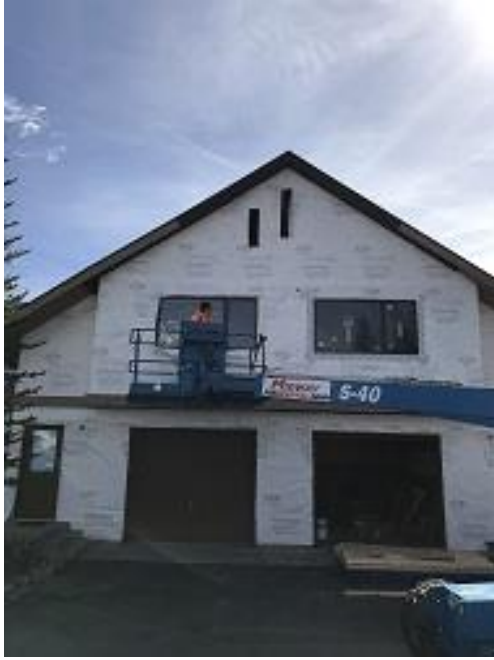
Bldg E3 Venting B
