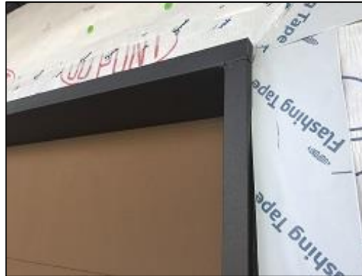
Bldg E3 Unit 27 Garage Door Metal Trim
