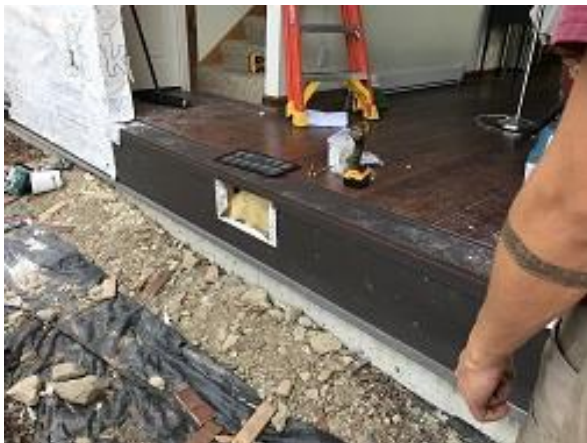
Building E3 Unit 24 Patio Door Flashing
