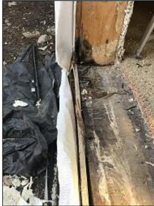
Bldg E4 Unit #31 Patio Door Framing Damage
