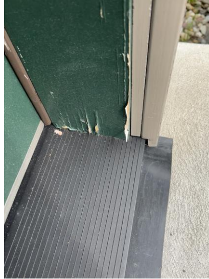
Building E7 Unit 49 Front Door Paint Peeling Moment
